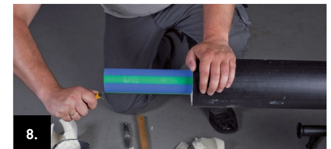
8. Abisoliertes Mediumrohr reinigen und Rohrende sowohl von innen als auch von außen entgraten.
